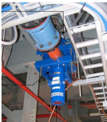
Figura 4. Medidor nuclear ubicado en zona de rebose de ciclón (fuente: Cs-137 de 5 mCi).
