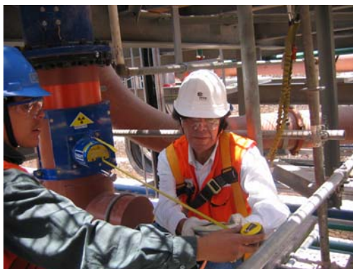
Figura 3. Verificación de tasa de dosis a 1 metro.
