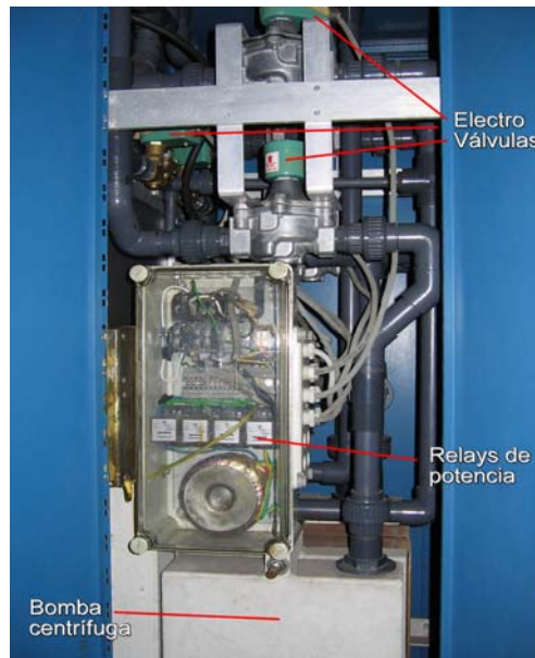
Figura 1. Imagen de las electroválvulas y relays de alta potencia.
